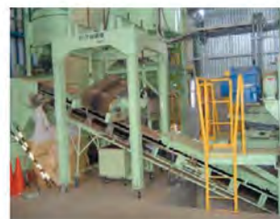
舟底型 腐木材処理プラント (鉄粉除去ライン)
