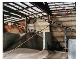
舟底型 堆肥プラント
