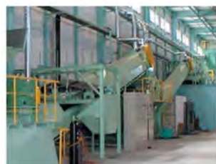
舟底型 廃木材搬送設備
