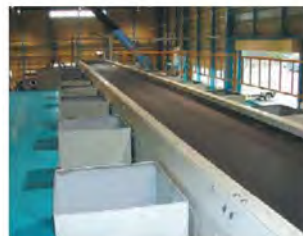
平型 廃プラスチック選別リサイクル設備
