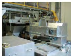
舟底型 灰固形化施設
