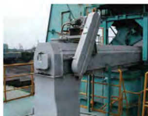
舟底型 土壌改良設備 投入コンベヤ
