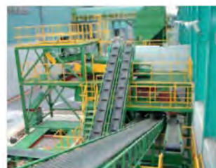
クライマ型 舟底型 腐木材処理プラント (チップ搬送コンベヤ)
