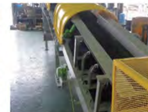
舟底型 高炉スラグ搬送コンベヤ
