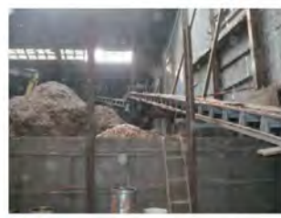
舟底型 木材チップ搬送コンベヤ
